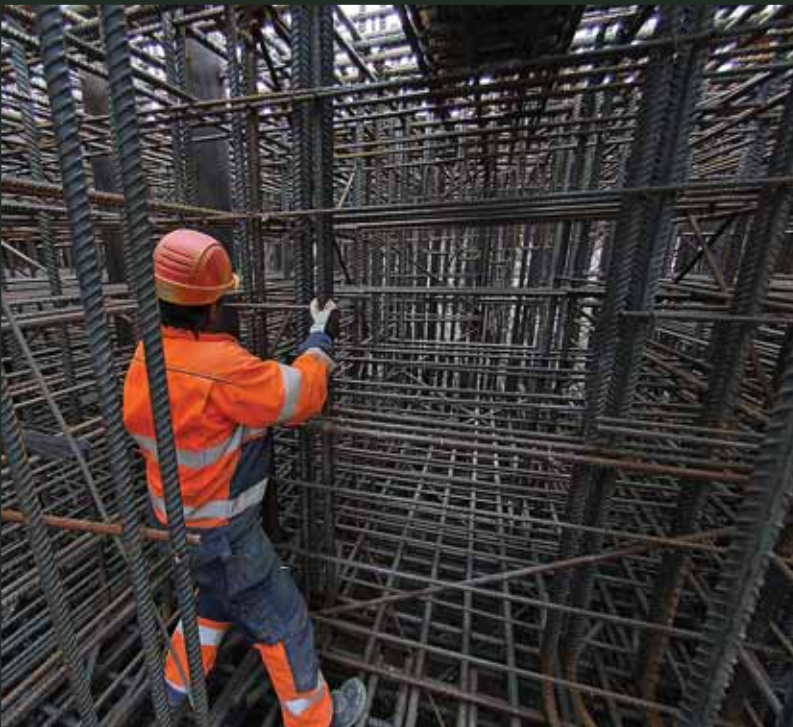
Uusi voimalaitos rakennetaan vankalle pohjalle. Kuva: TVO
