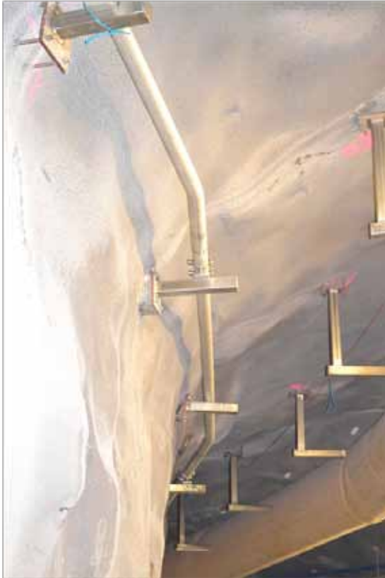
Kuva 15. Putkistot ja niiden kannakkeet ydinvoimalaitoksella. Lähde: LVT-Putki Oy
