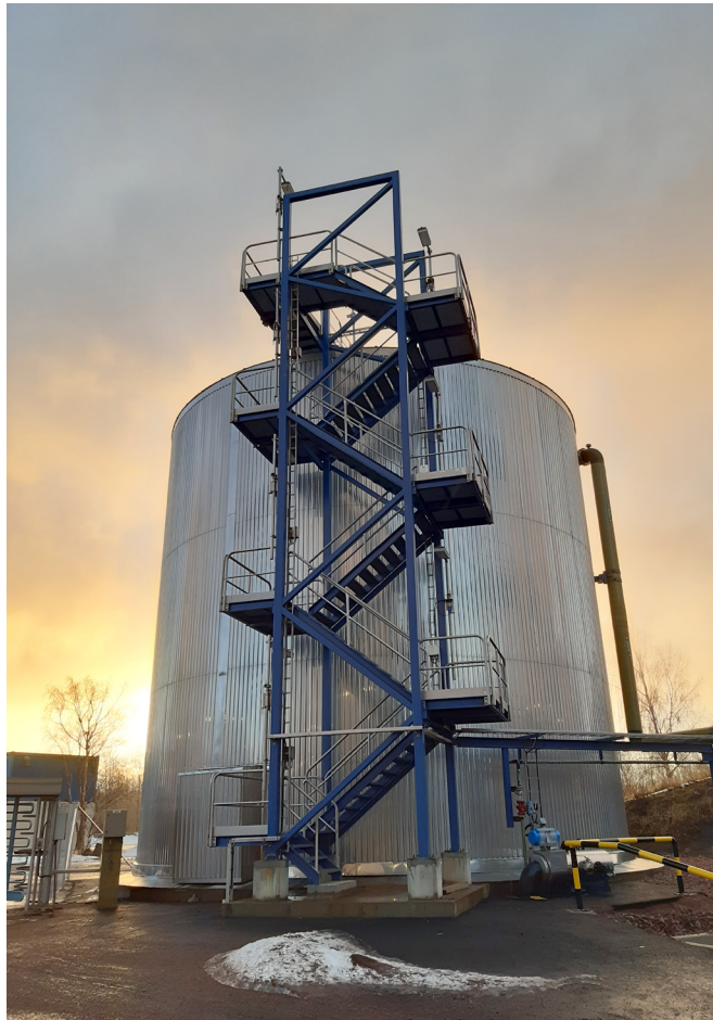
1 400 m 3 kokoinen hulevesisäiliö Harjavallan Suurteollisuuspuistossa. Kuva: Boliden Harjavalta.
